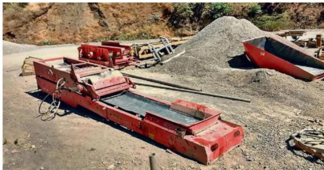
Abandono. Las labores en el portal de salida se paralizaron el 4 de agosto y en el portal de entrada, el 7 del mismo mes.
